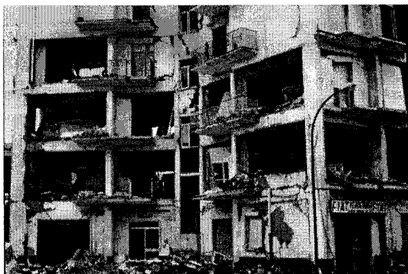
Slika 14. Oštećenja usled dejstva zemljotresa
