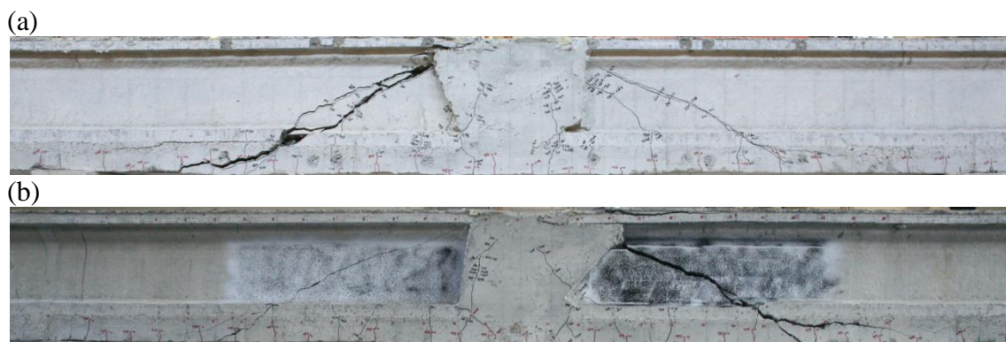
Slika P .1-10: 350-135/135-1: Prikaz prsline nakon loma grede: na južnom (a) i severnom licu grede (b)
