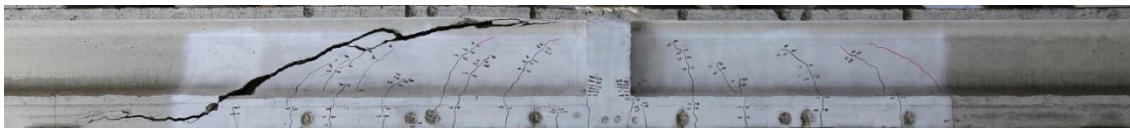
Slika P .7-10: 350D-185/80: Prikaz prsline na južnom licu grede nakon loma
