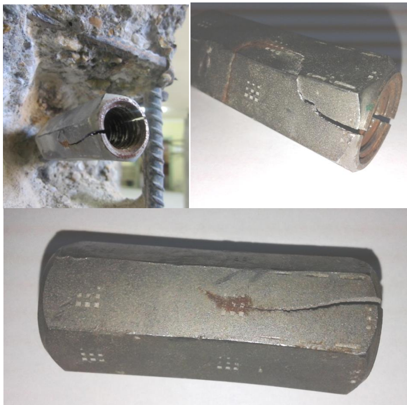
Slika 3.49 Oštećena mehanička spojnica izvađena iz ispitivanog uzorka
