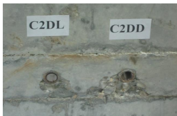
Slika 3.41 Uzorak C2 – detalj oljuskavnja betona ispod smičućeg konektora
