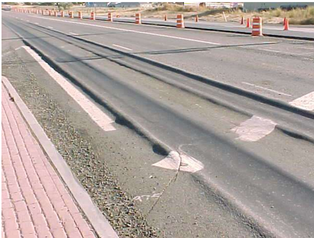
Slika 2.13 Trajne deformacije asfaltnih slojeva
