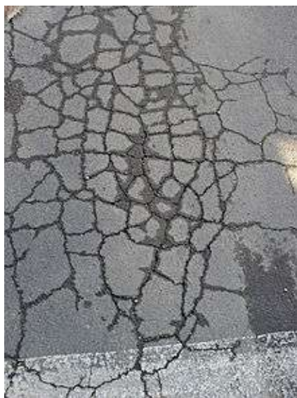
Slika 2.24 Oštećenja asfaltnih slojeva usled zamora
