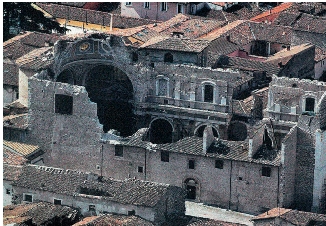
Figure 4.4. The church of S. Maria Paganica in L'Aquila after 2009 earthquake, © Direzione Regionale Abruzzo.
