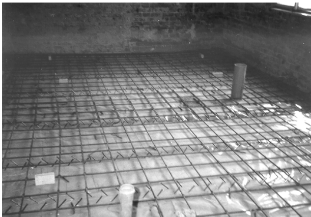
Slika 11. Izgled međuspratne konstrukcije na zgradi Glavne pošte u Arandelovcu neposredno pre betoniranja
