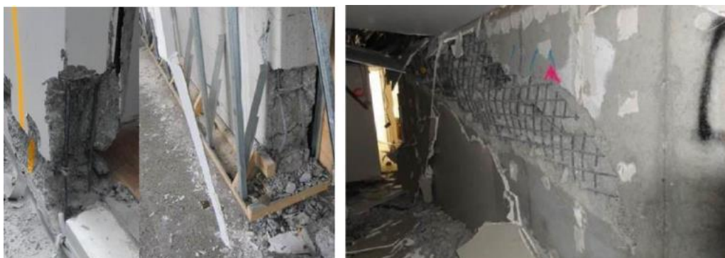
Slika: 5.15 a) lom izvijanjem armature, b) dijagonalni lom AB zida pritiskom (Kam i dr., 2011)
