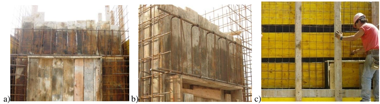
Slika: 9.2 Primeri loše obrade detalja armature greda i otvora u sastavu AB zidova (foto: P. Petronijević)
