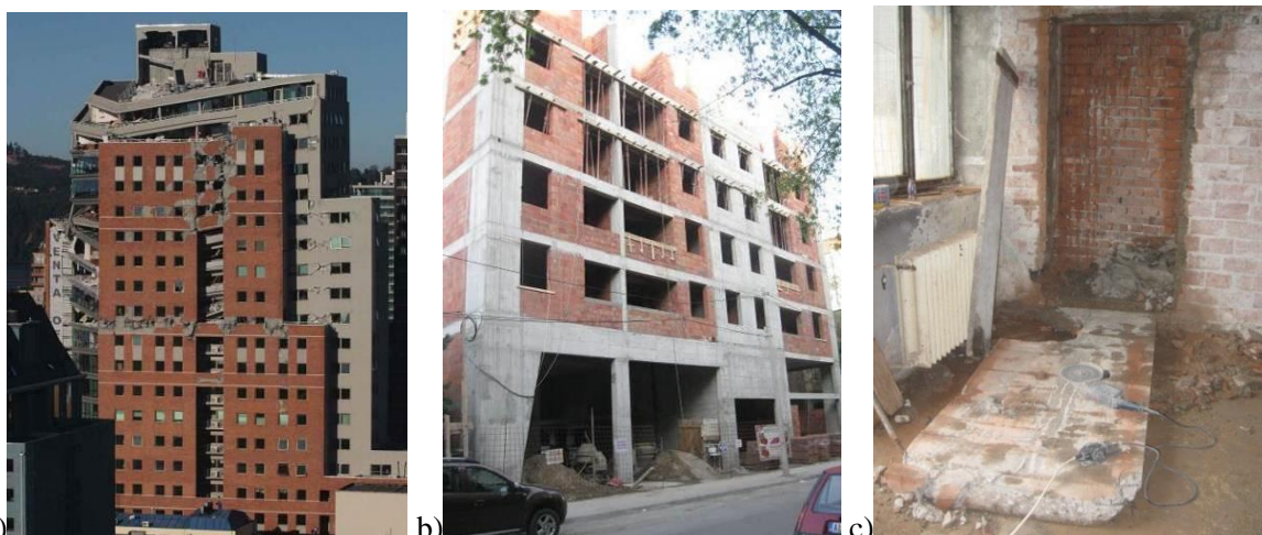
Slika: 6.10 a) Torre O'Higgins zgrada Maule zemljotres, Čile 2010. slika: (PEER, GCR 14-917-25) ), b) primer neregularnog toka bočnih sila po vertikali objekta (slika P. Petronijević), c) naknadna intervencija na otvaranju otvora u prizemlju AB zida, zgrada GAF-a Niš, (slika: P. Petronijević)
