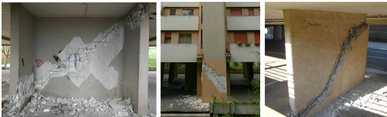
Slika: 5.14 (levo) Dijagonalni lom AB zida l'Aquila zemljotresa 2009. [ http://eesd.epfl.ch/seismic-RC-core-walls ], (desno) Maipú, Čile 2010. (slika: Dr. Guillermo Franco)
