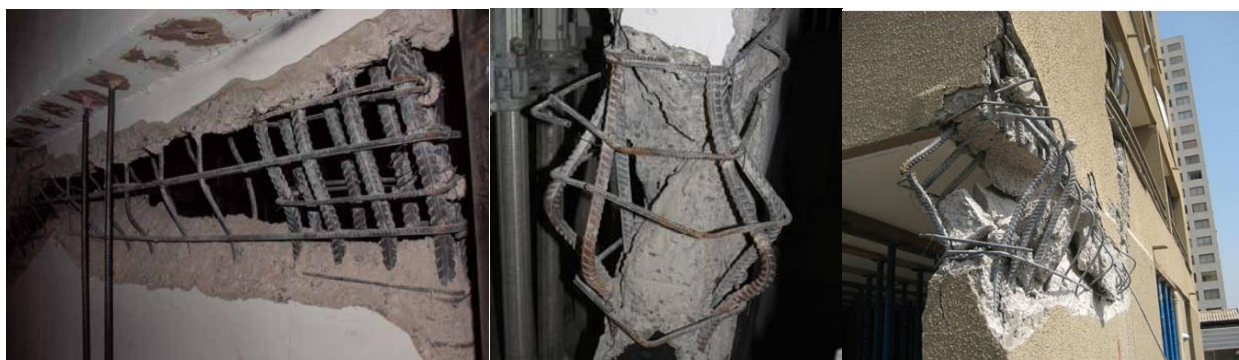
Slika: 5.18 a) Oštećenje zida bočnim izvijanjem armature, Santiago. (Wallace i dr., 2012); b) Čileu februar 27, 2010, (slika: Dr. Guillermo Franco)
