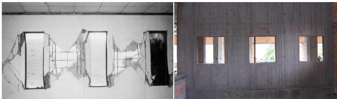
Slika: 2.12 karakteristična oštećenja kosim pukotinama (Osteraas and Somers 1996), slika: (EERI Publication 95-03/2), (desno) ponovljena geometrija otvora i međustubaca (novi blok KC Niš)
