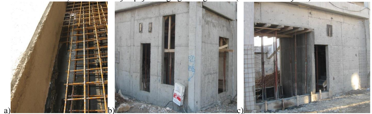
Slika: 9.4 a) potpuni izostanak sidrenja armature rebra u ivično ojačanje izvedeno u prvoj fazi, b) preterano slabljenje AB jezgra, c) nerazumno slabljenje AB zida u prizemlju, (foto: P. Petronijević)
