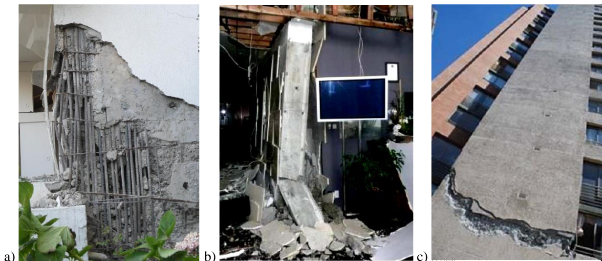
Slika: 5.17 a) Drobljenje ivične zone i izvijanje armature; b) lom AB zida izbočavanjem, Novi Zeland 2011. (Elwood et al. 2011); c) Edificio Plaza Mayor Čile 2010, (slika: El Mercurio)
