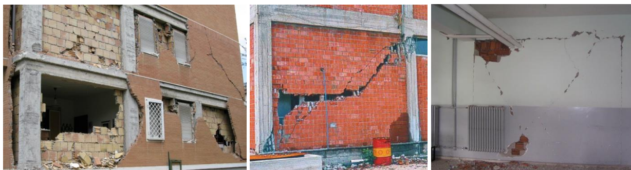
Slika: 8.19 Oštećenja zidova ispune, (Sozen i dr., 1999)
