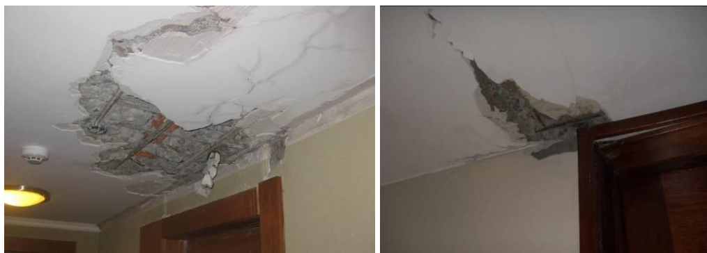
Slika: 6.19 Oštećenja na mestu spreznja AB zidova međuspratnom konstrukcijom
