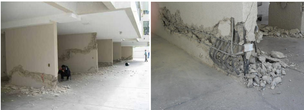
Slika: 5.16 a) Oštećenje zida, Vina del Mar, (slika: P. Bonelli), b) Lom betona drobljenjem-neadekvatno utegnuta ivična zona zida (slika: Wallace i Moehle, 1992)
