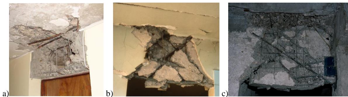
Slika: 9.1 Primeri oštećenja veznih greda u stambenom prostoru
