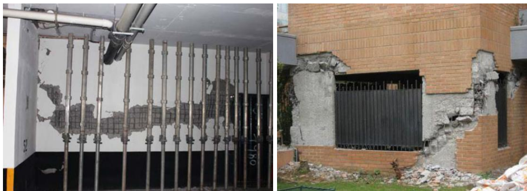
Slika: 5.21 Smičući lom neregularnih AB zidova oslabljenih otvorom
