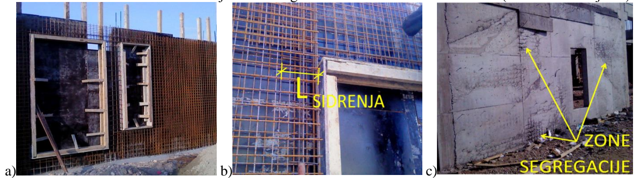
Slika: 9.3 a) loše pozicioniranje otvora u prizemlju, b) neadekvatno oblikovanje detalja armature otvora, c) loše betoniranje i pojava segregacionig znezda (foto: P. Petronijević)
