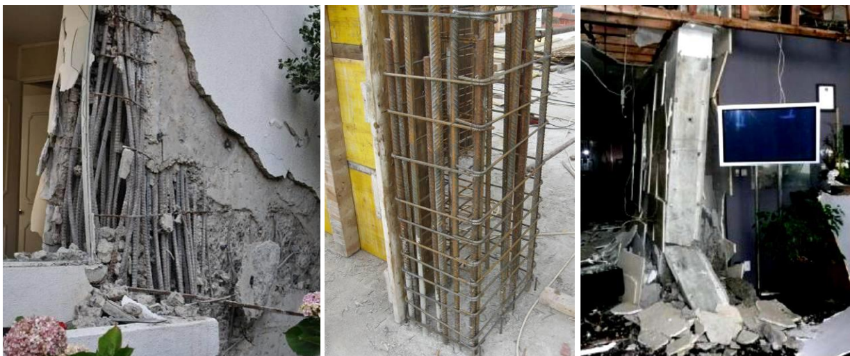
Slika: 4.5 Prikaz neadekvatno utegnuto ivičnog dela AB zida (Čile, 2010), ivčna zona zida bez adekvatnog poprečnog utezanja (Niš, 2015) (slika: P. petronijević), New Zealand (Elwood et al. 2011)
