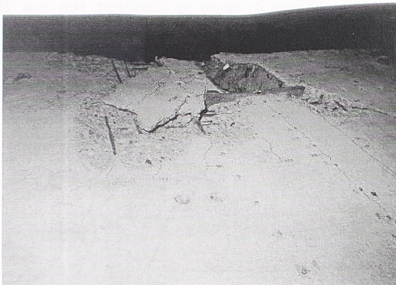
Slika 4.28 Gornja površina ploče nakon loma posle uklanjanja otpalog betona, model S3
