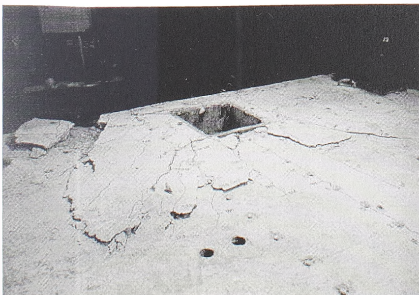
Slika 4.27 Gornja površina ploče nakon loma pre uklanjanja otpalog betona, model S3
