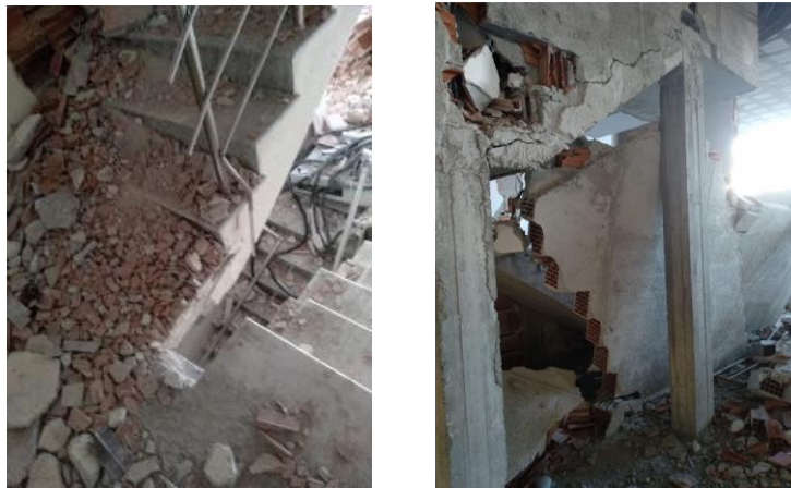
Slika 7-7: Oštećeno stepenište u „fleksibilnoj zgradi“ u Draču ( Durrës )
