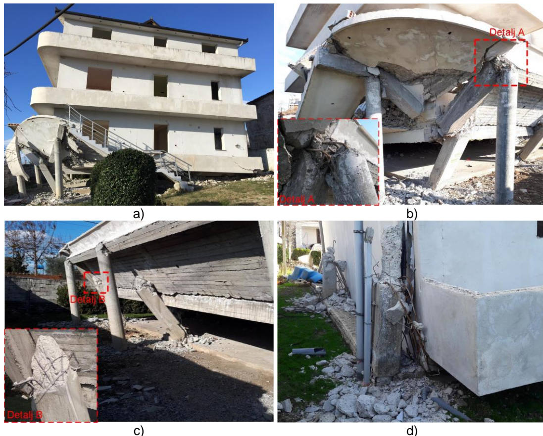
Slika 4-3: Kolaps privatne kuće u mestu Tumanë (Thumanë) sa „fleksibilnim spratom“: a) istočna strana; b) jugozapadna strana; c) južna strana; d) severna strana
