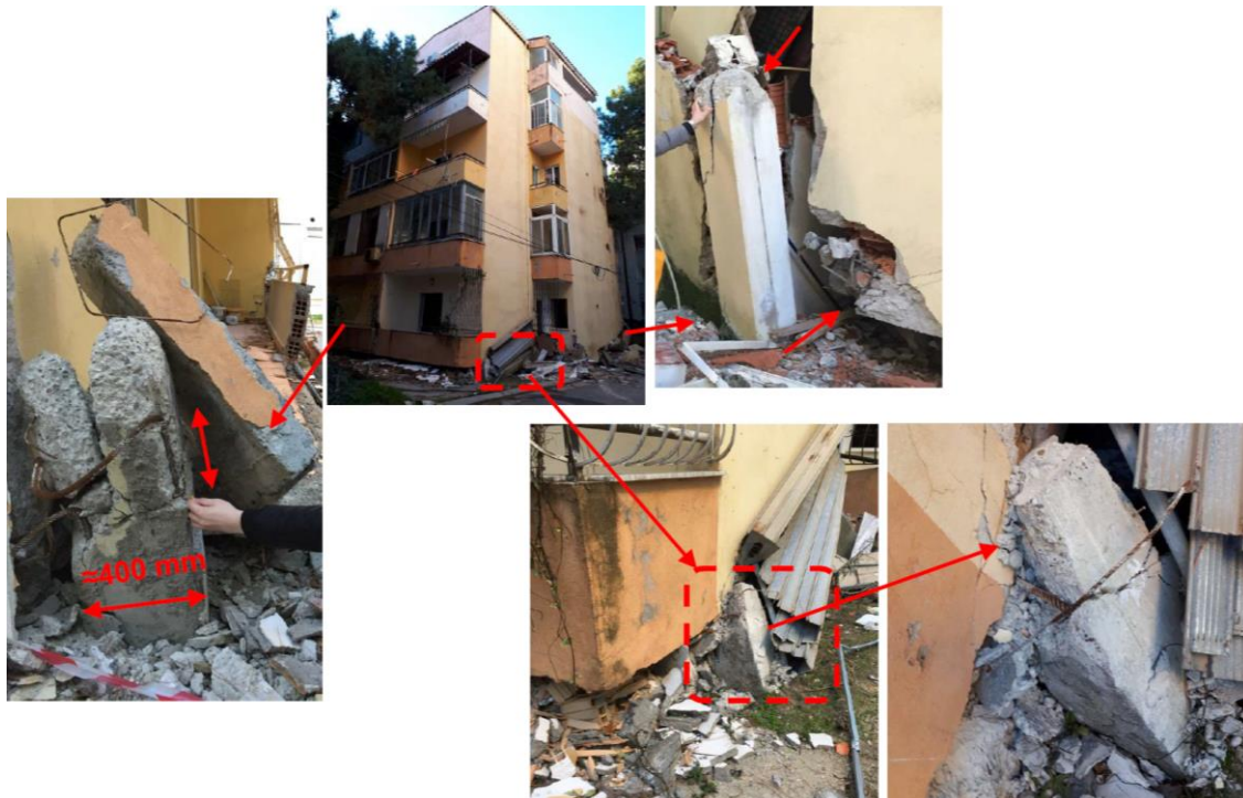
Slika 5-13: Srušena zgrada sa hibridnim konstrukcijskim sistemom: detalji AB konstrukcije u prizemlju (naselje Shkëmbi i Kavajës na jugu Drača)
