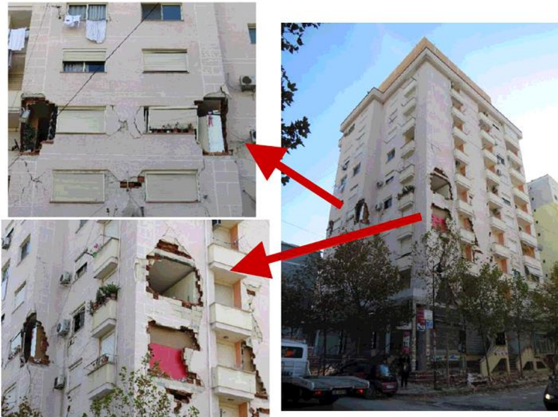
Slika 4-20: Oštećenje i ispadanje ispune van ravni na zgradi u Draču (Durrës)
