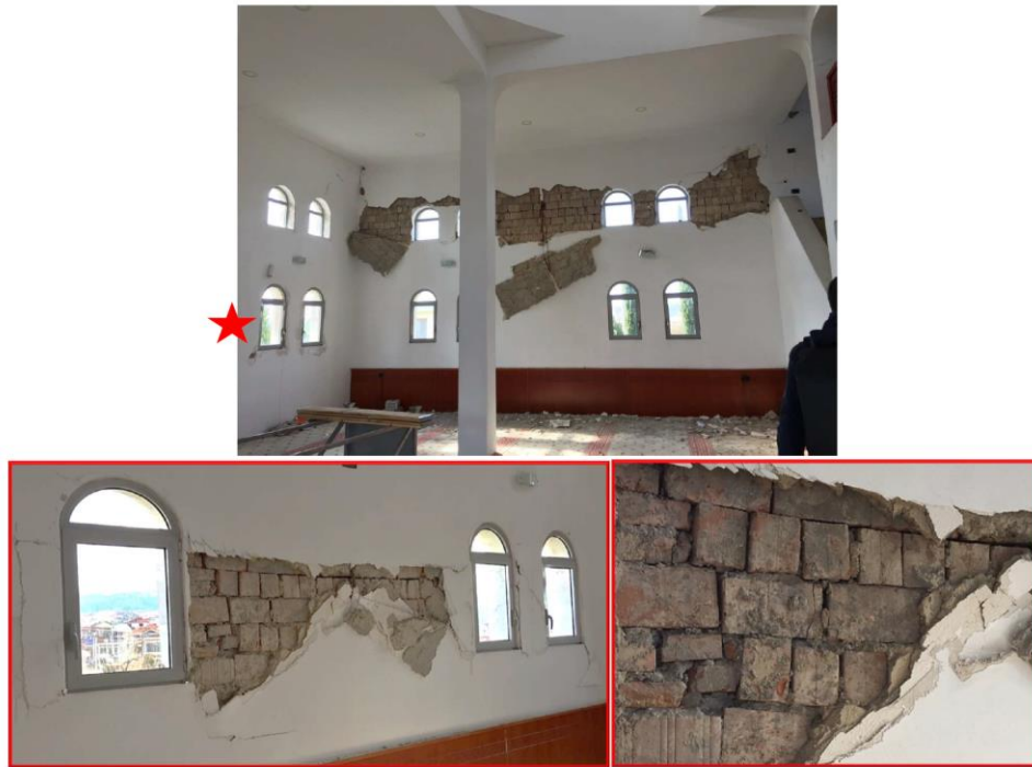
Slika 5-18: Unutrašnjost džamije u mestu Tumanë (Thumanë): oštećenja severnog zida (gornja slika) i istočnog zida (označen crvenom zvezdom na gornjoj slici a detalji su uokvireni crveno bojom)
