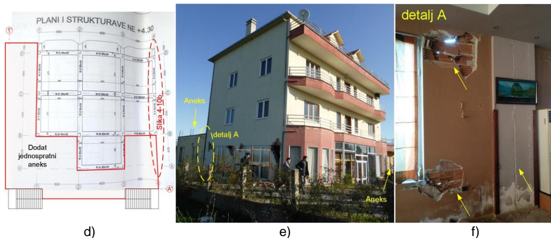
Slika 4-11: Nekonstruktivna oštećenja trospratne kuće na periferiji Tirane (Tiranë): a) Osnova prvog sprata; b) oštećenja zgrade, i c) oštećenja zidane ispune
