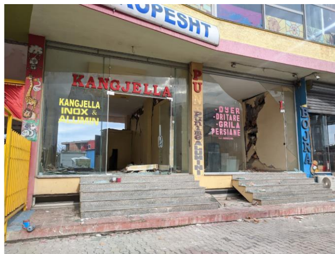
Slika 7-6: Prekid poslovanja usled nekonstruktivnih oštećenja u Draču (Durrës)
