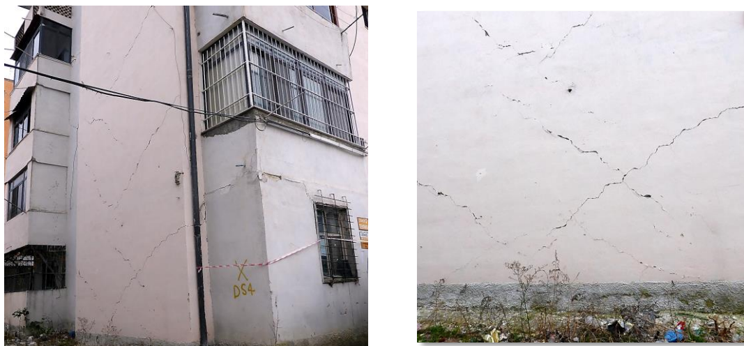
Slika 5-9: Oštećenje nearmirane zidane zgrade sa 5 etaža, Fuše Kruja
