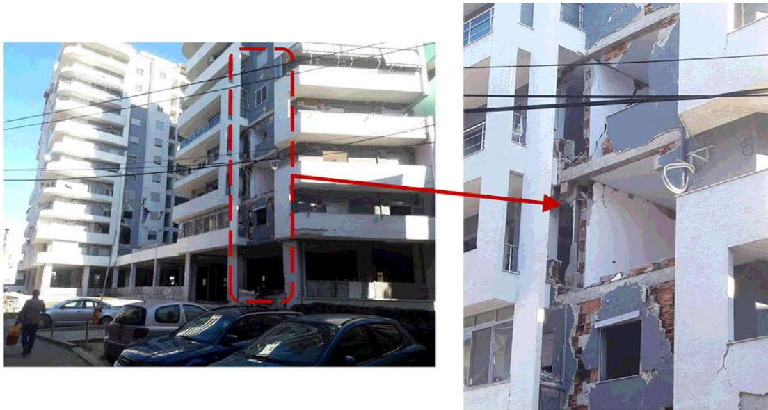
Slika 4-21: Oštećenje i ispadanje ispune van ravni na zgradi u Draču (Durrës)
