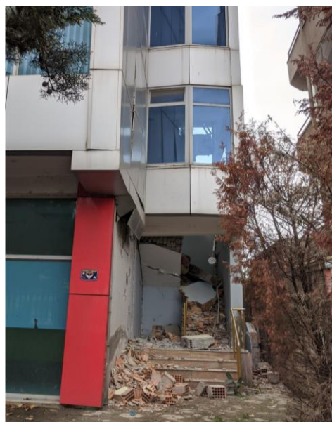
Slika 7-4: Oštećena zidana ispuna je blokirala stepenište
