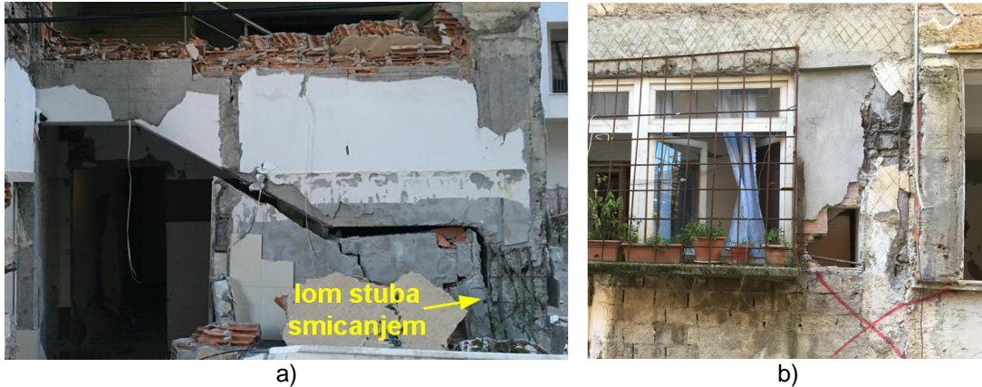
Slika 4-5: Primeri oštećenja AB zgrada usled „efekta skraćenog stuba“: a) uticaj oslanjanja stepeništa na stubove i b) uticaj parcijalne zidane ispune po visini stuba
