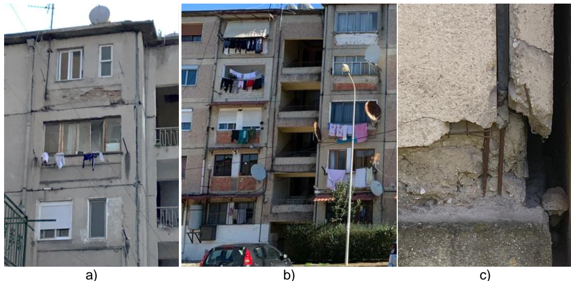
Slika 4-29: Stanje krupnopanelnih zgrada u Albaniji: a) propadanje fasadnih elemenata; b) ispunjavanje prostora zidarijom (renoviranje) i c) propadanje betona i korozija armature na nivou prizemlja
