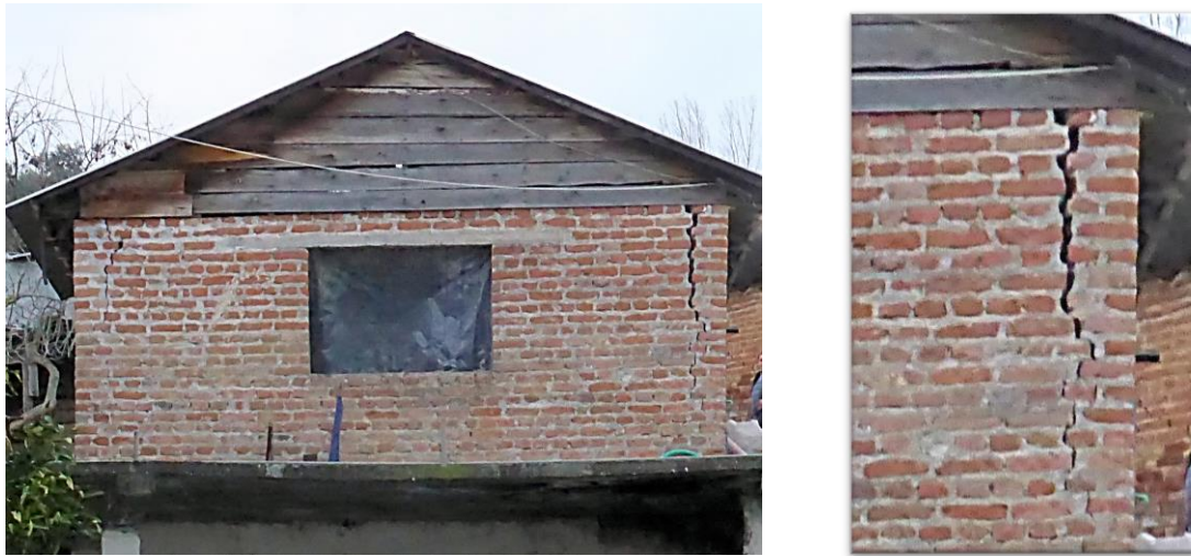
Slika 5-6: Oštećenja nearmirane zidane zgrade sa fleksibilnim drvenim krovom usled dejstva zemljotresa upravnog na ravan zida, selo Bubć
