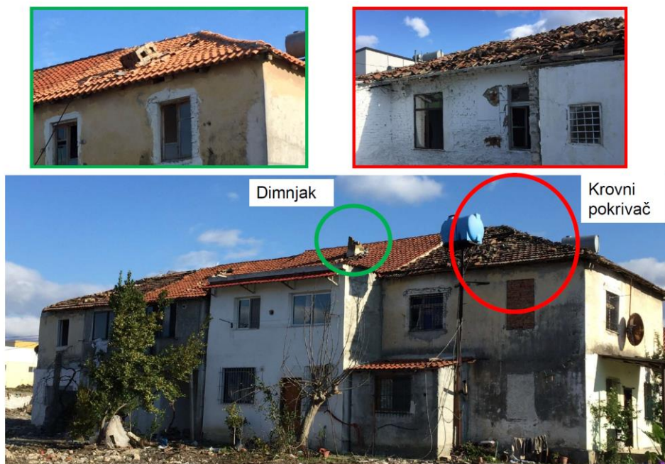
Slika 5-14: Oštećenja nekonstruktivnih elemenata niskih zidanih zgrada
