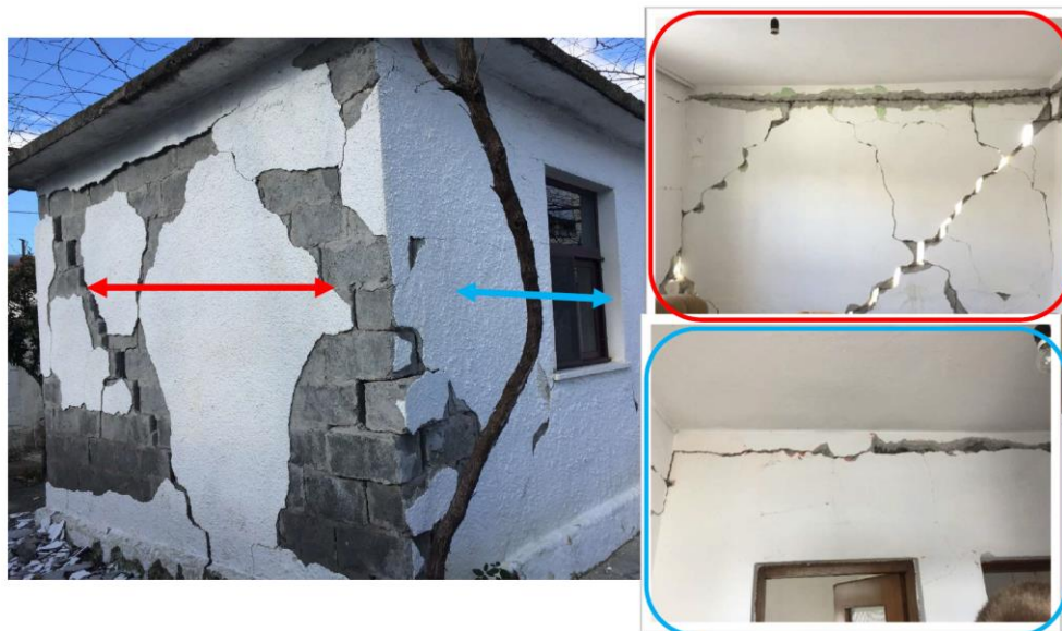
Slika 5-7: Prizemna zidana zgrada od betonskih blokova u mestu Tumane – oštećenja u ravni zida (crveno) i upravno na ravan zida (plavo)
