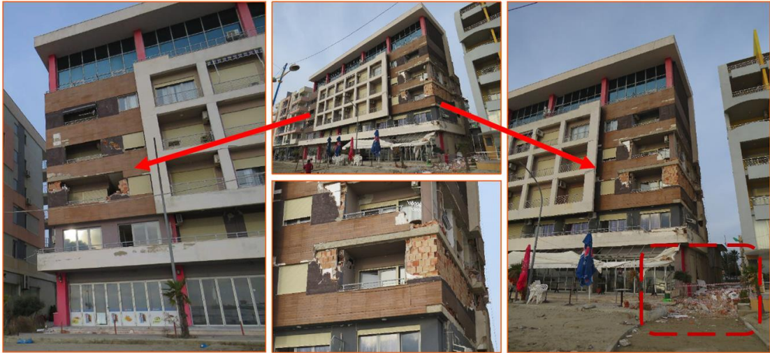
Slika 4-19: Oštećenje i ispadanje zida van ravni na zgradi u priobalnoj zoni Drača (Durrës)
