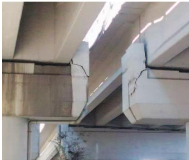
Slika 6-1: Oštećenja nadvožnjaka u blizini Drača ( Durrës ) (UNDP, WB, i EU, 2020)
