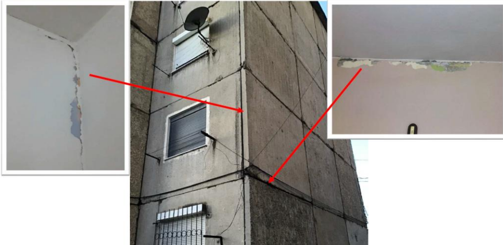
Slika 4-30: Oštećenja krupnopanelnih zgrada na spojevima između horizontalnih i vertikalnih panela, Tirana (Kombinat)
