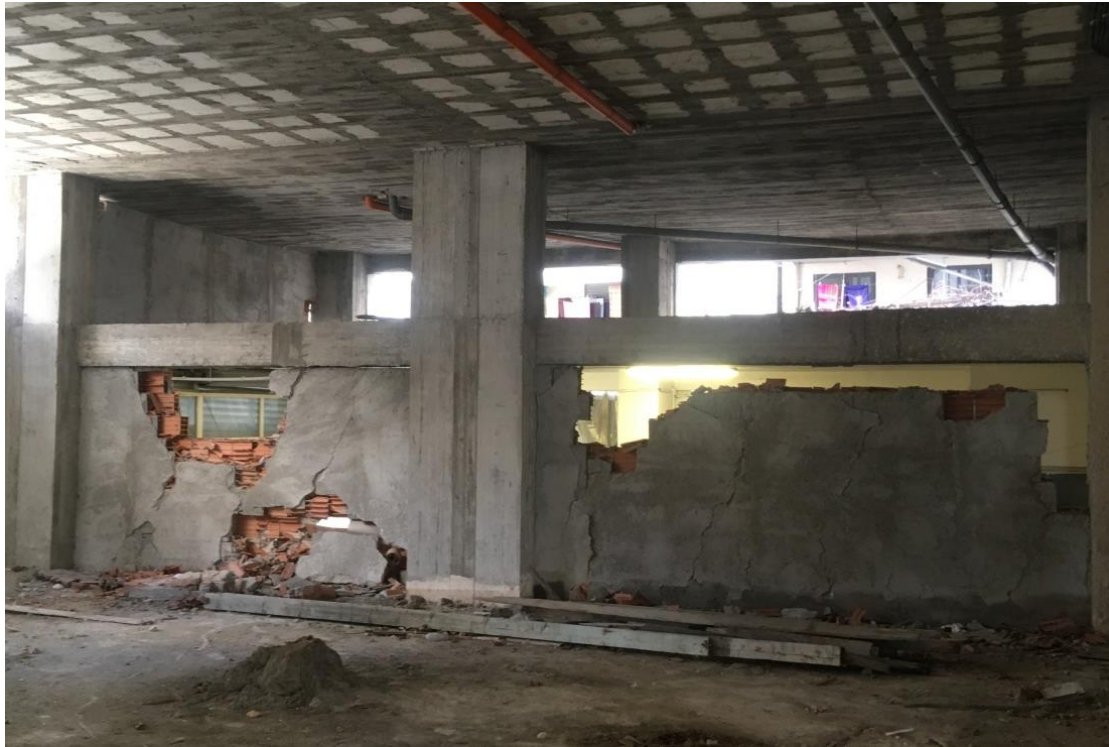
Slika 4-23: Oštećenje i ispadanje ispune van ravni unutar zgrade u Draču (Durrës)
