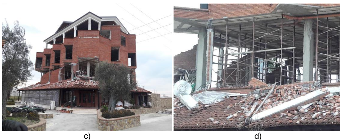
Slika 4-4: Oštećenja četvorospratne zgrade u blizini sela Bubq (Bubq): a) jugoistočna strana i b) istočna strana
