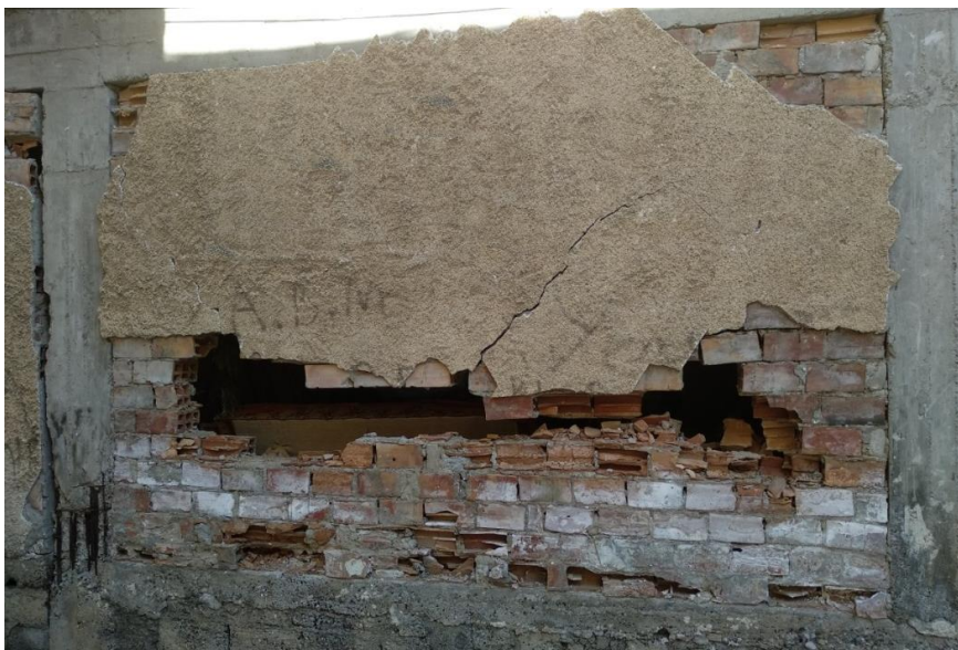
Slika 4-16: Lom zidane ispune izbočavanjem u sredini
