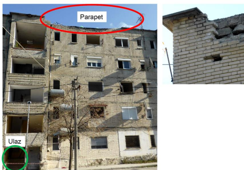
Slika 5-15: Oštećenja parapeta zidane zgrade sa 5 etaža u Tirani
