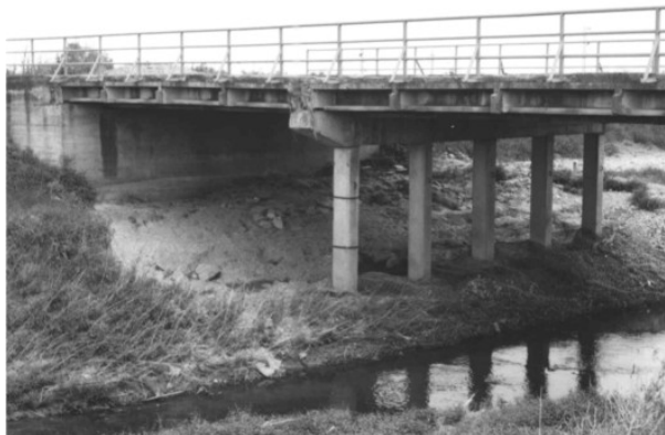
Slika 12.24: Erozijska korita u mostovskom suženju i oštećenje kolovozne konstrukcije prolaskom poplavnog talasa (reka Rača, most na putu Markovac – Lapovo).
