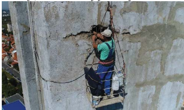
Slika 2 - Degradacija betona po celoj debljini AB zida dimnjaka na visini od oko 70m
