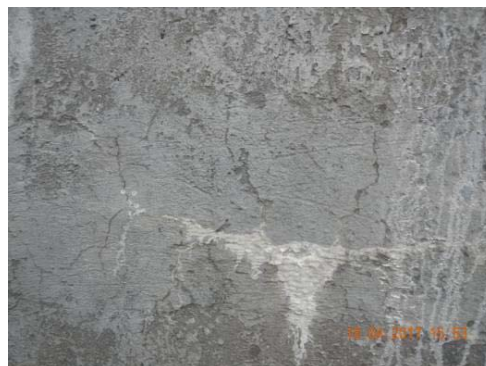
Slika 3 - Mrežaste pukotine i kalcifikacija na AB zidu dimnjaka
