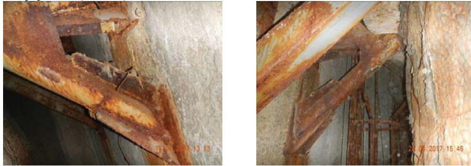
Slika 5 - Korozija konzola za nošenje dimovodne cevi
