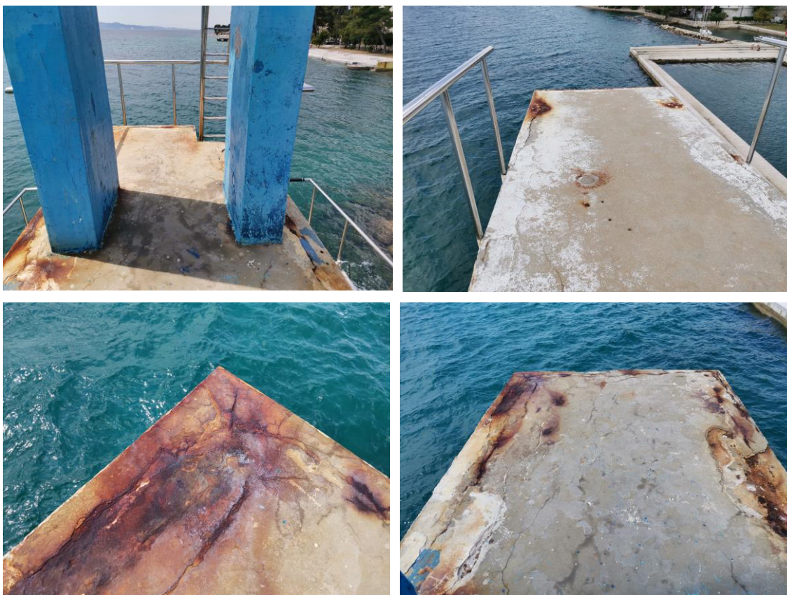
Slika 3. Oštećenja skakaone koja su posljedica uznapredovalog procesa korozije armature
