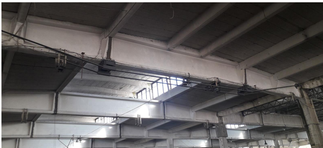
Slika 3. Glavni krovni nosač ojačan čeličnom zategom, u osi 14 (B-C)
