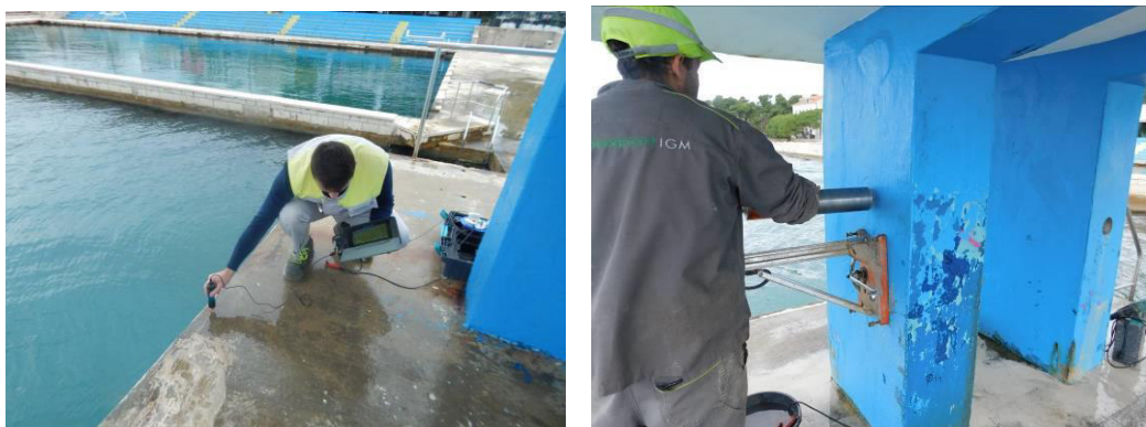
Slika 2. Mjerenje stupnja korozije armature (lijevo) i vađenje uzoraka betona iz konstrukcije (desno)
