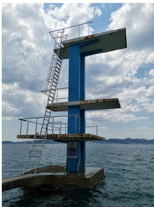
Slika 1. Pogled na oštećenu morską skakaonu i pristupni most
