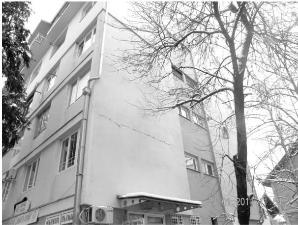
Slika 12. Pukotine na fasadi
