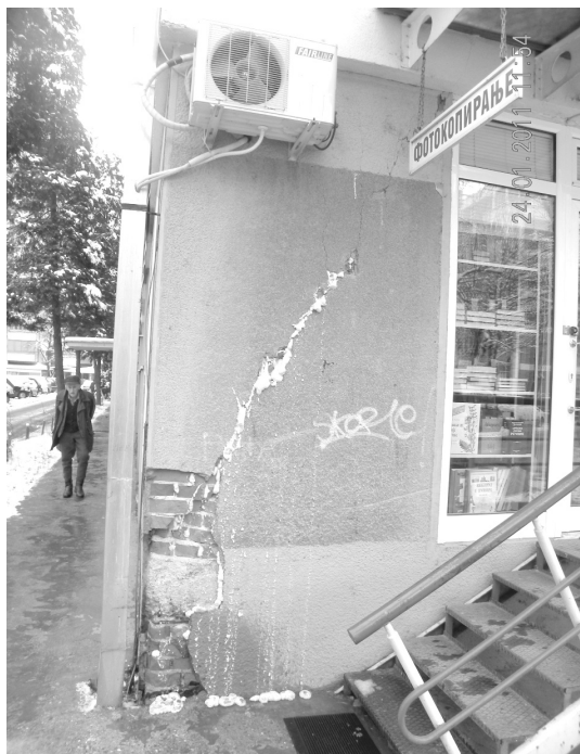
Slika 13. Pukotina u fasadnom zidu i lokalno drobljenje opeke na ivici zida
