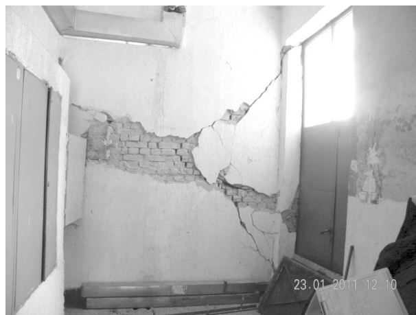
Slika 7. Jedno od tipičnih oštećenja nosećih zidova
