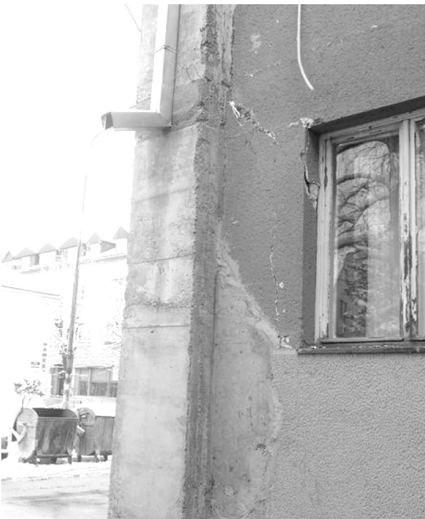
Slika 2. Detalj već saniranog oštećenja na kalkanu zgrade kod ulaza 1 sa kratkom pukotinom u zidu veličine otvora preko 4mm
