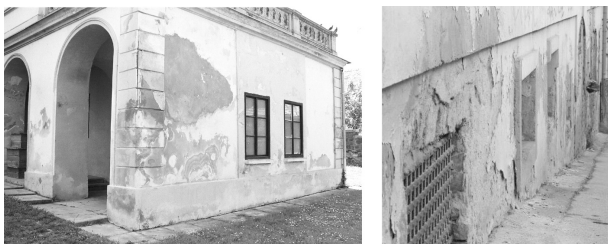
Slika 28. Oštećenja zidova usled dejstva vlage
