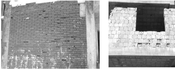
Slika 26. Oštećenja šupljih opeka i blokova usled dejstva mraza
