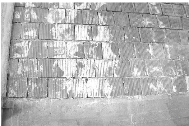
Slika 29. Iscvetavanje soli na površini blokova za zidanje
