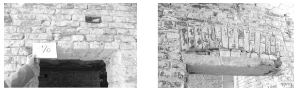
Slika 8. Pogrešno izvedeni otvori u zidovima
