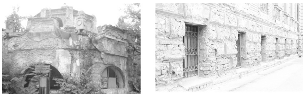
Slika 27. Oštećenja maltera u masivnom zidu usled dejstva mraza
