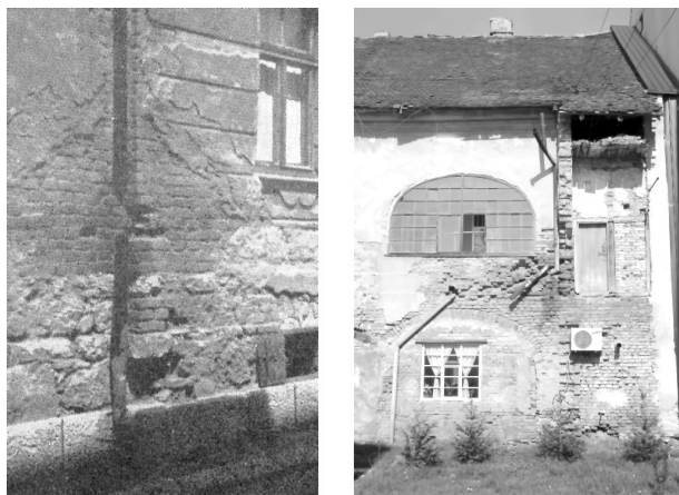
Slika 18. Oštećenja zidova usled neodržavanja oluka i neadekvatnog odvođenja vode sa i od zgrade
