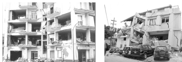
Slika 19. Oštećenja objekata usled dejstva zemljotresa
