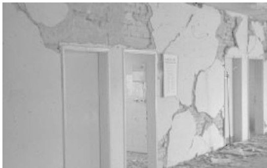
Slika 14. Unutrašnji zid zidane zgrade oštećen dejstvom zemljotresa
