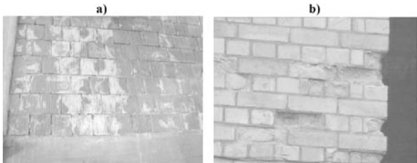
Slika 8. Primer iscvetavanja soli na zidu izvedenom od blokova za zidanje (a) i izgled zida izvedenog od opeka neotpornih na dejstvo mraza (b)
