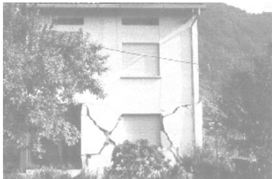
Slika 13. Fasadni zid zidane zgrade oštećene dejstvom zemljotresa
