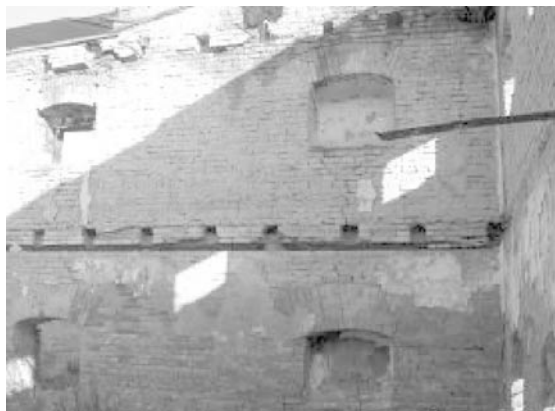
Slika 15. Zid jednog starog objekta oštećen požarom: vidi se da supune opeke u dobrom (očuvanom) stanju, da je sa zida u potpunosti otpala malterska obloga i da postoje pukotine u zidu usled termičkog "rada" zida
