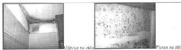
Slika 7. Posledice kondenzacije vlage na "hladnim" zidovima
