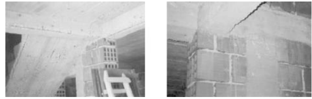
Slika 10. Pogrešno postavljeni blokovi za zidanje
