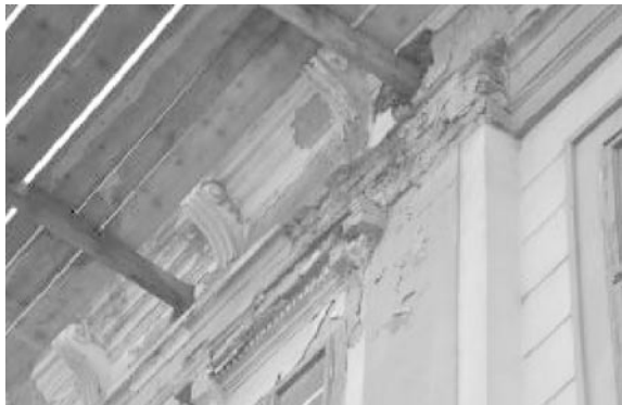
Slika 19. Primer oštećenja fasade usled neispravnog horizontalnog oluka
