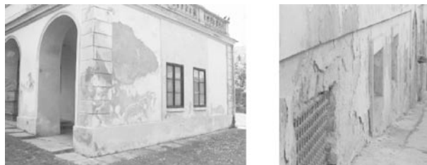
Slika 2. Posledice vlaženja zidova usled nepostojanja hidroizolacije koja će sprečiti kapilarno podizanje vlage prisutne u tlu
