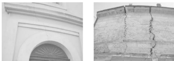
Slika 1. Prsline i pukotine u zidovima usled sleganja temelja
