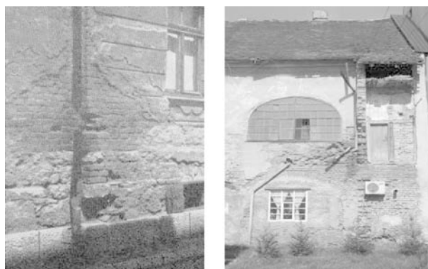
Slika 18. Primeri oštećenja zidnih površina usled neispravnih olučnih vertikala
