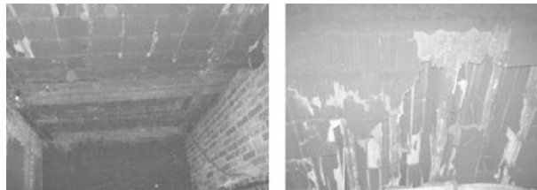
Slika 16. Uticaj požara na zid od pune opeke i međuspratnu konstrukciju jednog objekta novijeg datuma: zid je u dobrom (očuvanim) stanju, dok je međuspratna konstrukcija sistema TM potpuno devastirana
