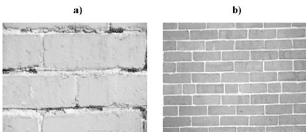
Slika 9. Nepravilno (a) i pravilno (b) izvedene malterske spojnice u zidu
