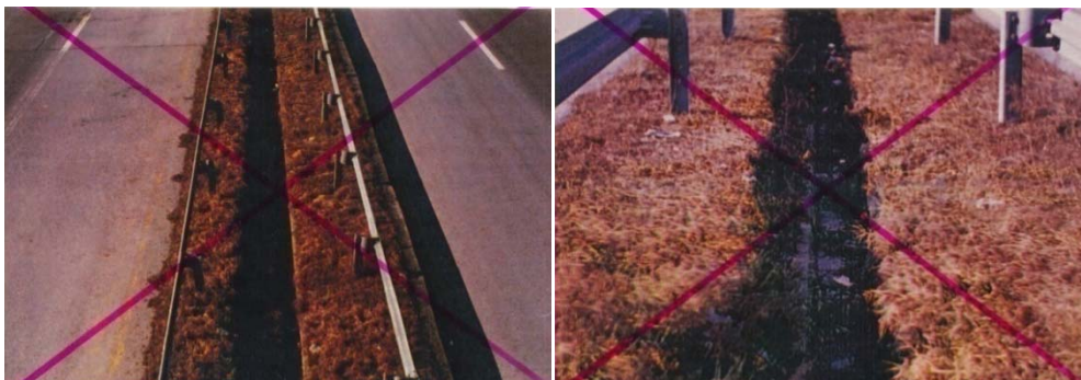
Slika 2: Postojeće stanje sistema za odvodnjavanje u razdelnom pojasu autoputa E-75
