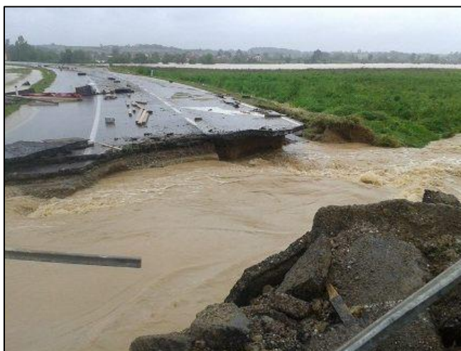
Slika 5. Oštećen put blizu Koceljeve u maju 2014. godine (izvor: www.koceljeva.gov.rs/index_files/htm/Poplave%20galerija.htm ).
