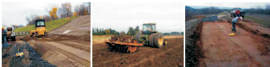
Slika 4.10: Izgradnja nasipa; sleva na desno: razastiranje i planiranje materijala iz pozajmišta; nabijanje tla u slojevima pomoću jež-valjka; kontrola zbijenosti sloja pomoću nuklearnog mernog uređaja [33].
