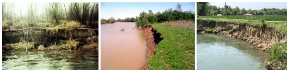
Slika 3.14: Erozijska obala na Dunavu, Velikoj Moravi i Vrbasu.
