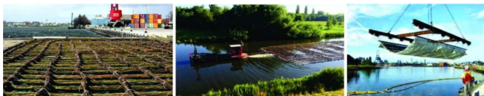
Slika 4.2: Ugradnja elastičnog temelja obaloutvrda; sleva na desno: fašinski madrac i njegovo odvoženje do mesta ugradnje [290]; polaganje podloge od geotekstila pomoću dizalice sa nosećim ramom [291].
