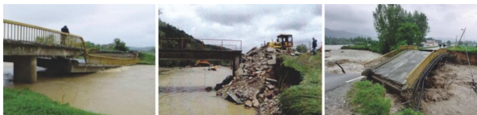
Slika 4.44: Oštećeni mostovi u vreme poplava; sleva udesno: r. Tamnava – Koce-ljeva, r. Ljig – Ljig (2014.) [36] i r. Ljubovača – Ljubovija (2020.) [294].
