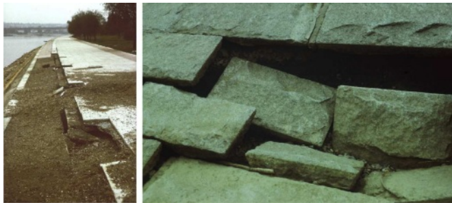
Slika 3.22: Primer deformacije obloge od slaganih kamenih blokova usled ispiranja peščanog filtra i stvaranja kaverni u osnovnom tlu (reka Sava u Beogradu).
