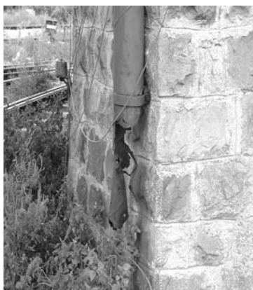
Slika 10. Deo postojećeg sistema za odvodnjavanje- oluk
