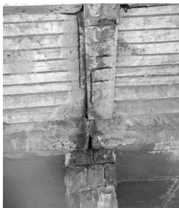
Slika 9. Konzole i grede pešačkih staza na prilaznim konstrukcijama
