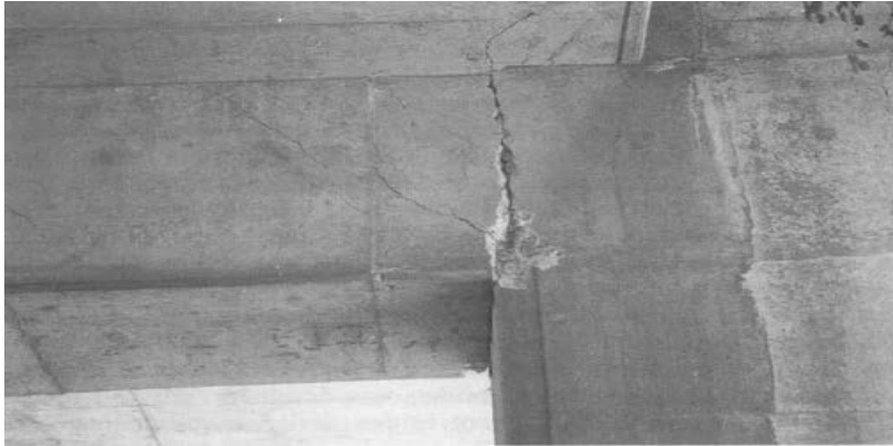
Slika 8 – Oštećenja čvora donjeg stroja, 1989. zemljotres u Loma Prieta-i [4]
