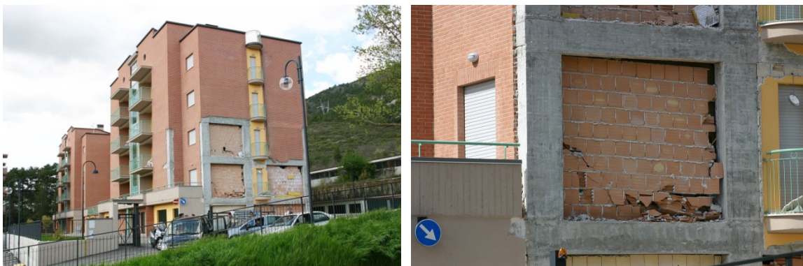
Slika 1. Oštećenje zidova ispunje pri zemljotresu u L'Aquila 2009 [2]
