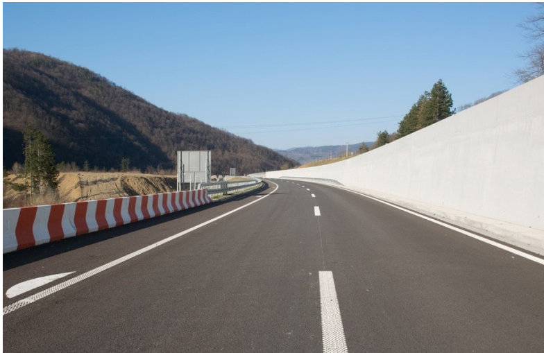
Slika 11. Neadekvatno uklapanje potpornog zida u postojeći teren [7]
