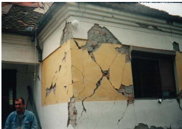
Slika 2. Tipičan oblik i raspored prslina kod zidanih konstrukcija Figure 2. Typical crack pattern of masonry structures.
