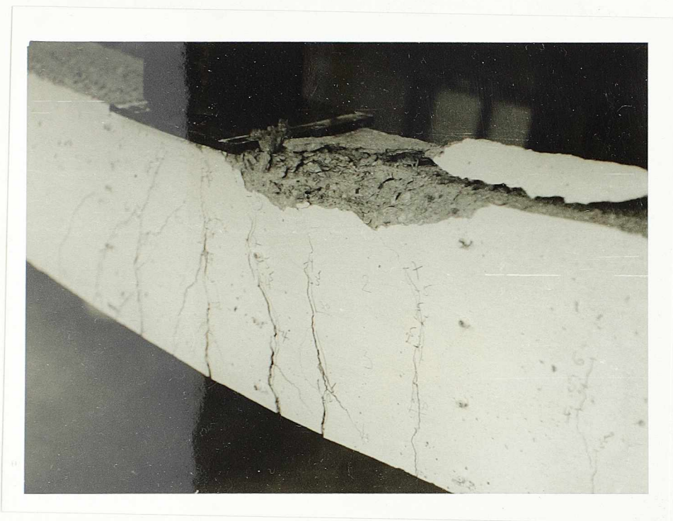
Sl. 11.15.- Lom betona (detalj )
