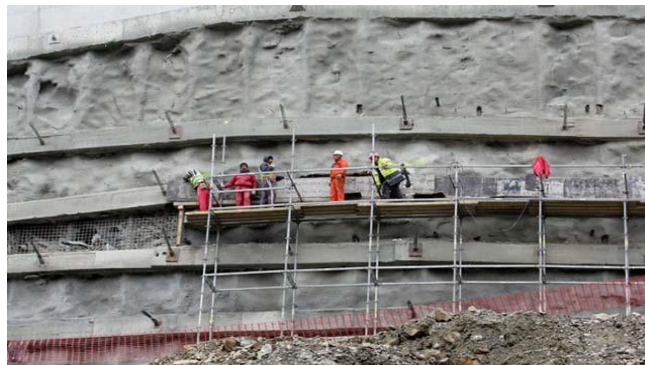
Слика 2 - Изглед дела скоро завршене потпорне конструкције (Извор: Грађевински факултет Универзитета у Београду, Институт за материјале и конструкције)
