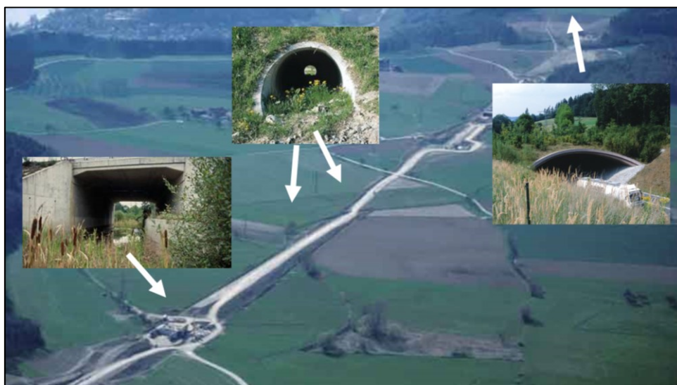
Slika 9. Inženjerski objekti koji omogućavaju komunikaciju i bezbedno kretanje životinjskih vrsta Izvor: (L1)
