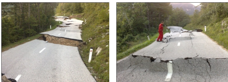
Slika 2: Oštećenja kolovozne konstrukcije nastala dejstvom klizišta u Sloveniji
