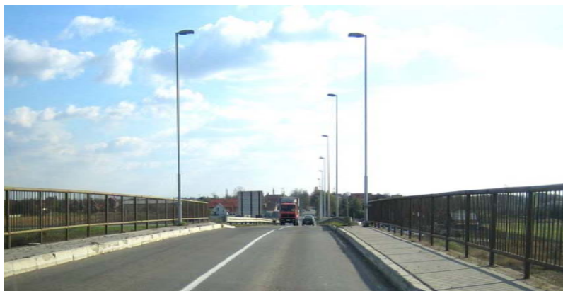
Slika 3: Primer previsokog oivičenja kolovoza na mostu
