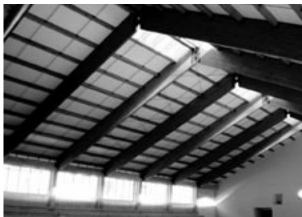
Slika 6. Sportska hala u Novoj Varoši. Statički sistem: ram na tri zgloba raspona 28,0 m
