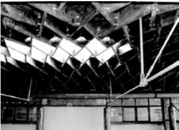
Slika 8. Prostorna krovna konstrukcija škole u Novom Sadu. Sistem Zolinger. Raspon 11m
