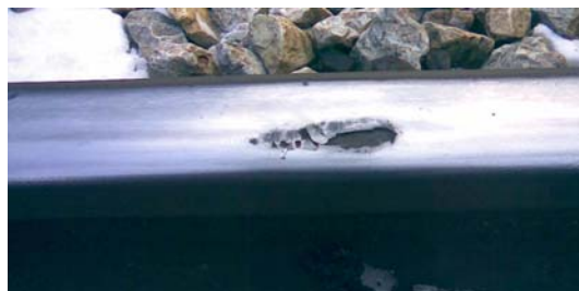
Slika 5 - Defekt tipa squat usled zamora šinskog čelika (kolosek na mostu preko reke Gradac na pruzi Beograd-Bar)
