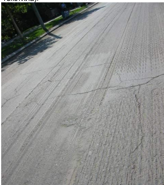
Слика 4. Стање површине након стругања застора
