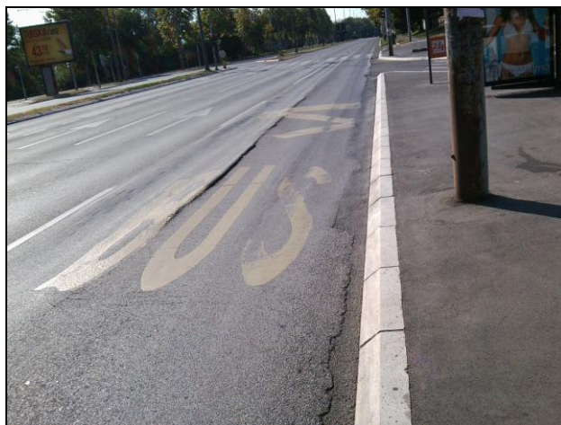
Слика 11. Колотрази на аутобуском стајалишту на десном коловозу
